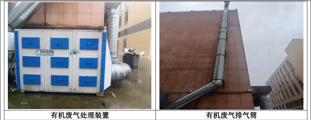
图 3-2 企业有机废气处理设施照片
